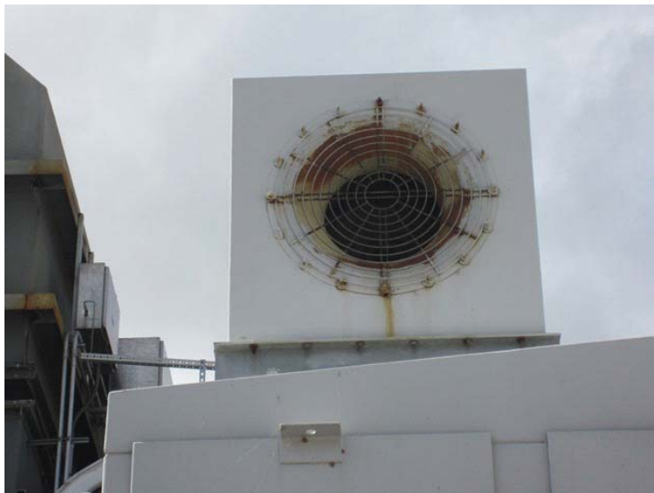
Minor corrosion on fan
