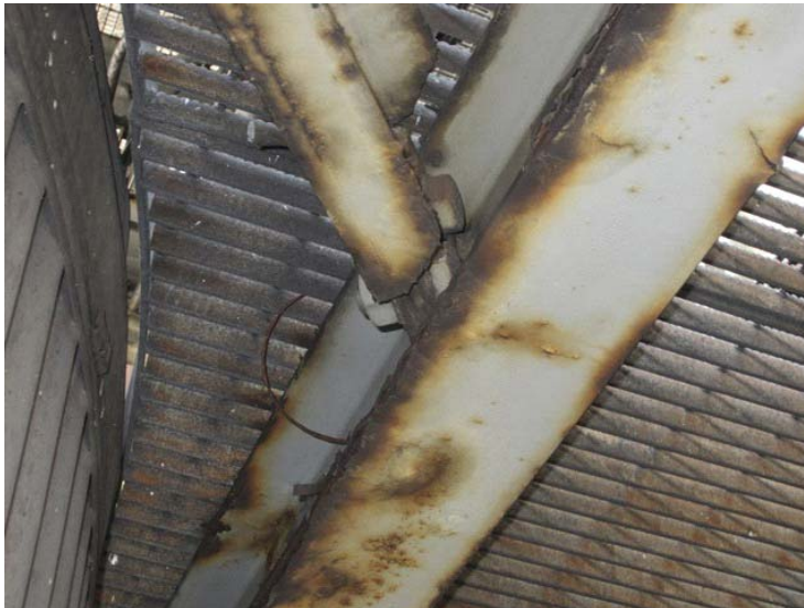
Heavy edge corrosion
