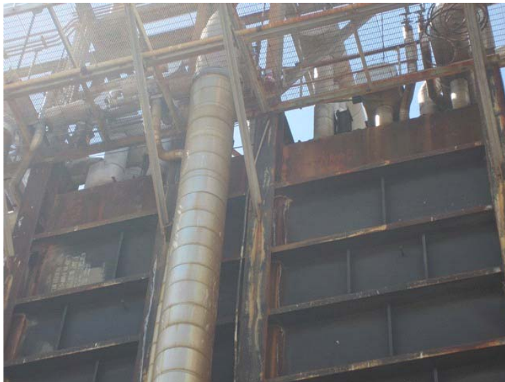
View of corrosion on HRSG skin
