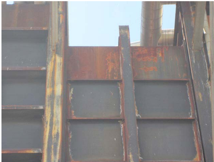
Heavy corrosion on HRSG
