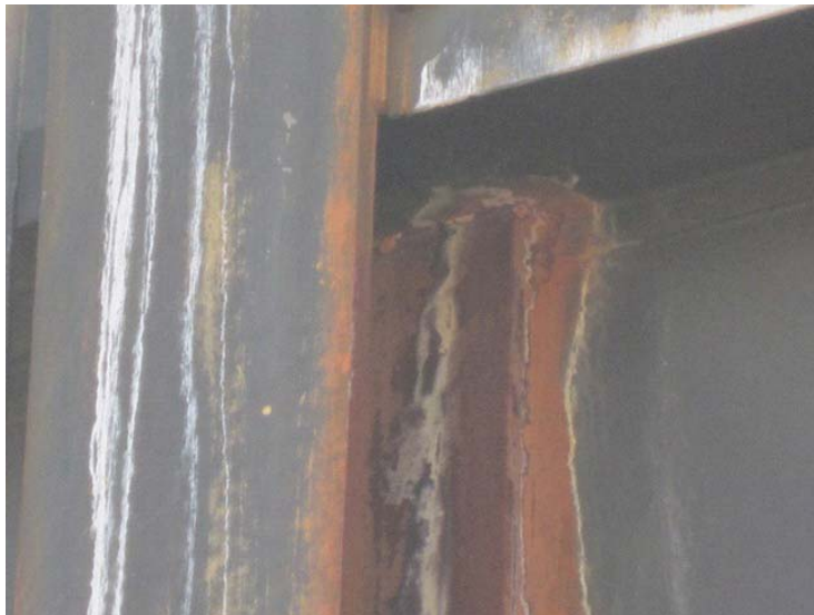
Corrosion on HRSG skin
