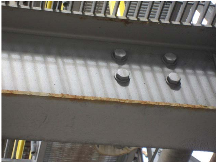
Minor edge corrosion
