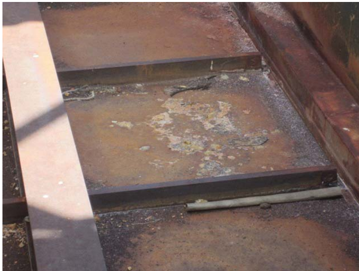
Corrosion on HRSG structure
