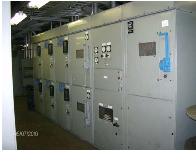
5kV MCC 1CYH-MSTR1
