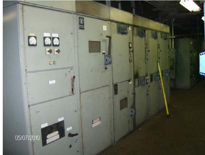
5kV MCC 1CYH-MSTR1
