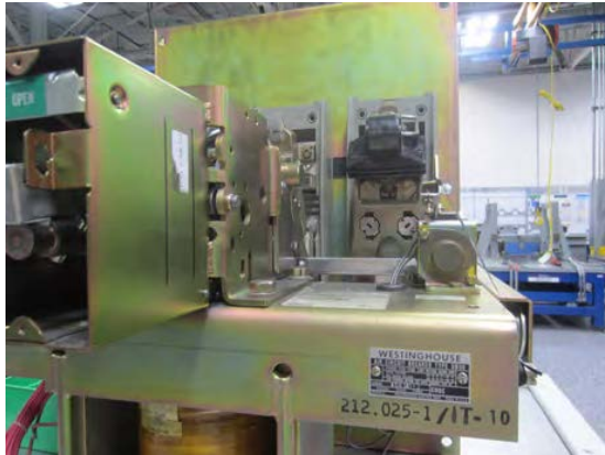
Breaker without the STA
