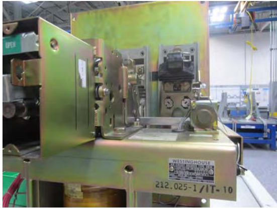
Breaker without the STA
