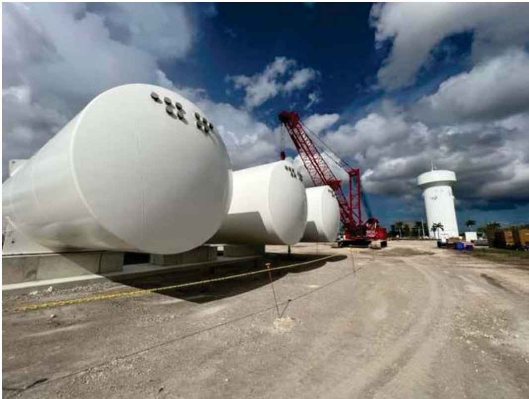
3 – 90,000-gallon LNG Storage Tanks
