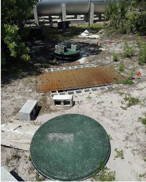
Photo # 58 – Effluent Vaults
