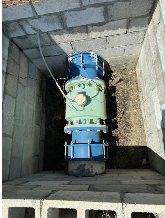
Photo # 59 – Effluent Flowmeter
